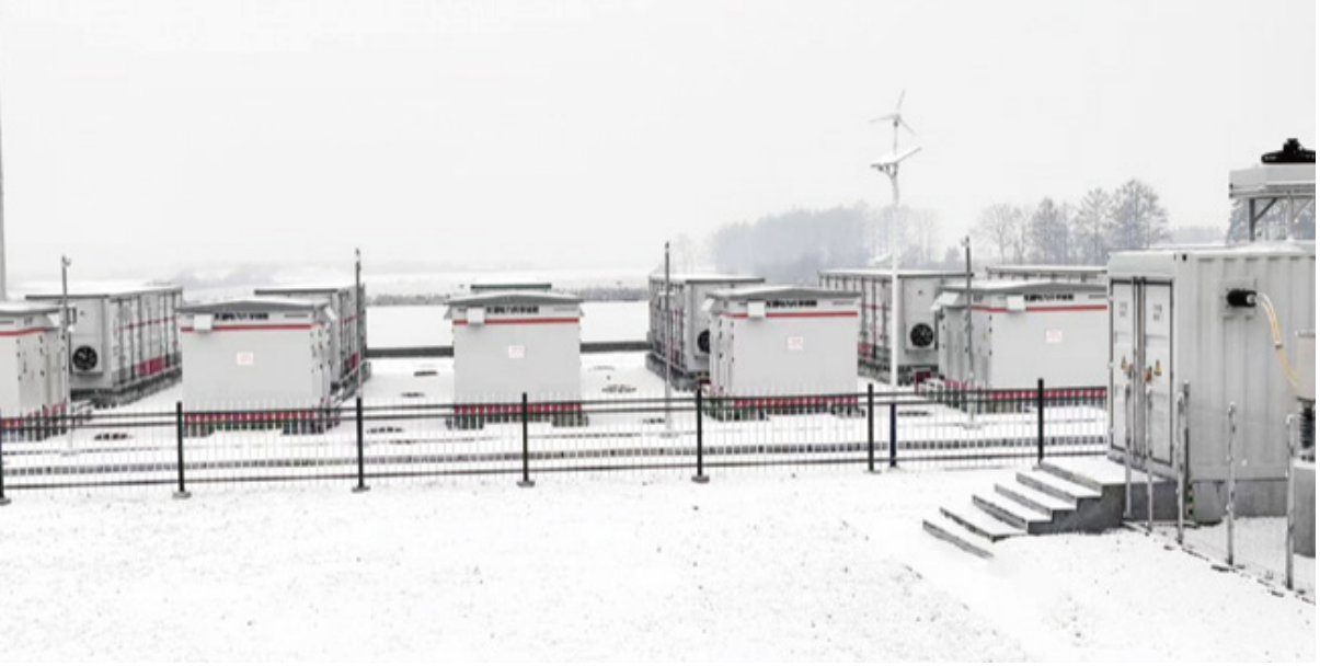
黑龙江伊春铁力年丰20MW风力发电20MW/40MWh储能项目 项目时间: 2024年 项目地点: 黑龙江伊春 项目特色: 风电配储、电网支撑
